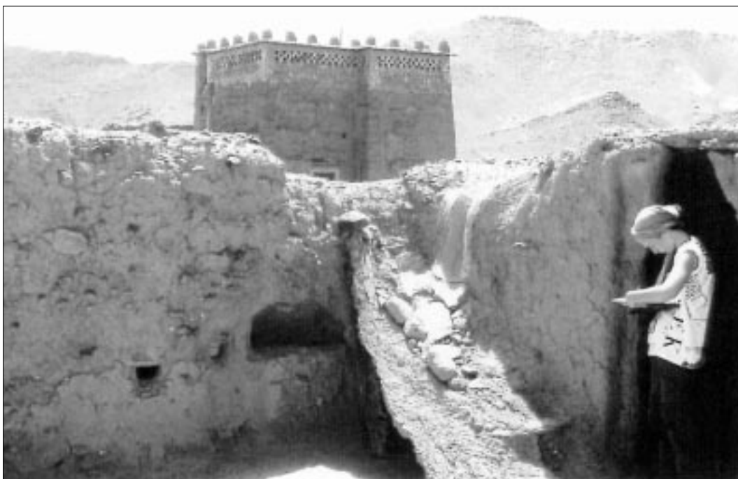
•Avaluació de l'estat de la kasba de Taghia
