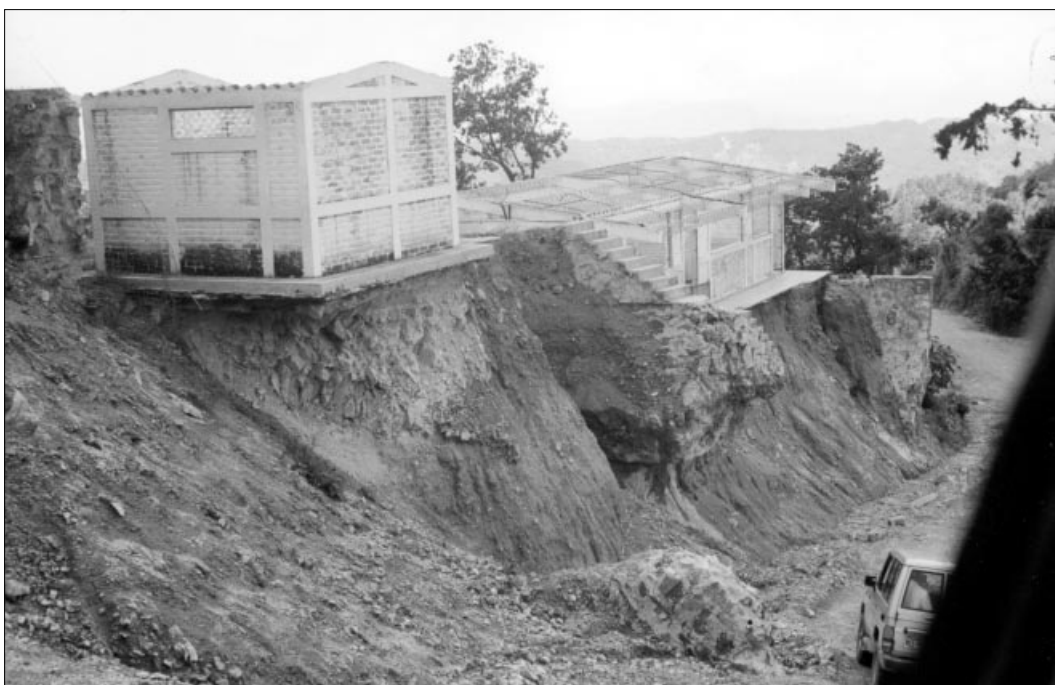
• Escola en construcció que va ser afectada per una de les esllavissades produïdes pel Mitch
