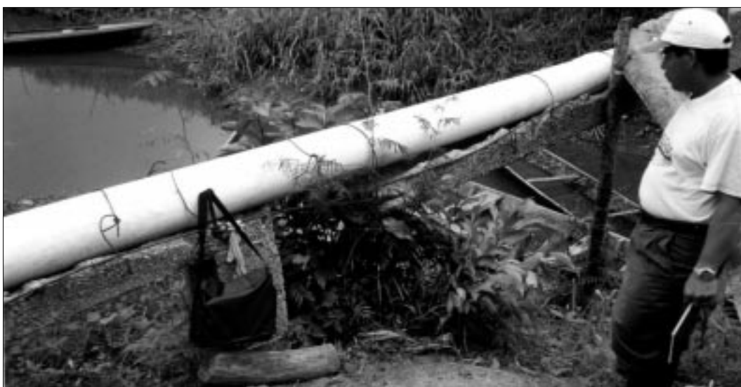
• Canonades d'aigües negres travessant un broc
