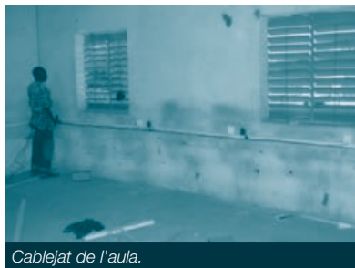
Cablejat de l'aula.
