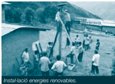
Instal·lació energies renovables.
