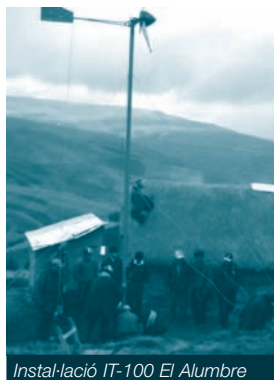
Instal·lació IT-100 El Alumbre
