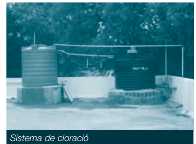
Sistema de cloració
