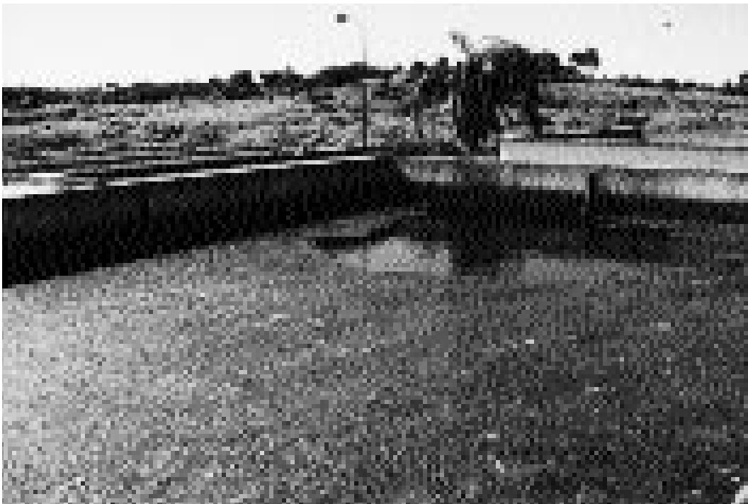
• Planta de tratamiento de aguas residuales.
