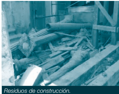
Residuos de construcción.
