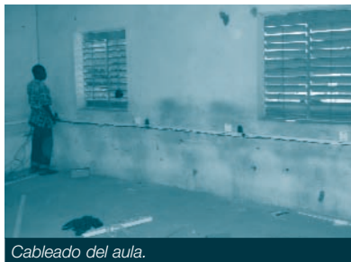
Cableado del aula.
