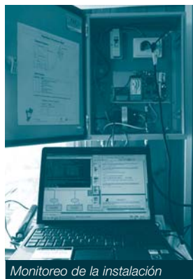
Monitoreo de la instalación
