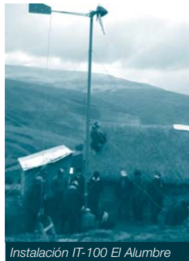
Instalación IT-100 El Alumbre
