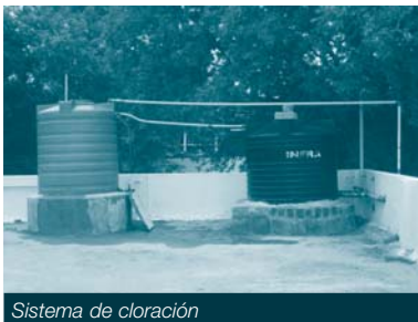
Sistema de cloración
